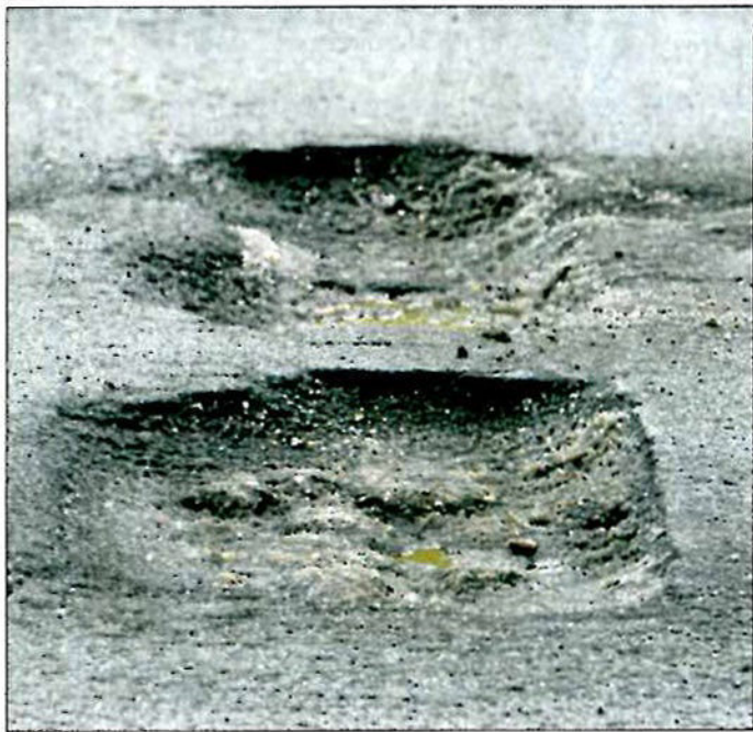
Die leeren Kassen der Kommunen und des Lands Baden-Württemberg führt oft zu schlechten Straßenbedingungen. Die Vergabe von Fördermitteln ist daher verändert worden. Foto: Wittek
